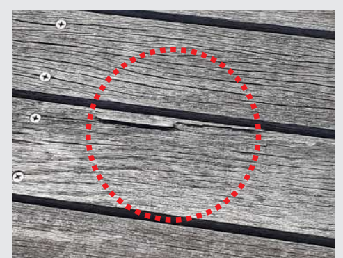
↑ ハードウッドの経年変化によるささくれの例
