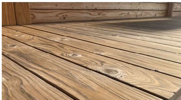
Gywood®のウッドデッキ無塗装材の経年変化。生物劣化に対する防腐防蟻性能を備えているが、無塗装材の場合、気象の影響による灰色化は避けられない。ただ、定期的な洗浄などの手入れを行うことでシルバークレーという経年美が生まれる。
